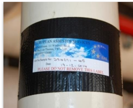
Σωλήνας που φέρει την ένδειξη αμιάντου. Πηγή: UEPG
