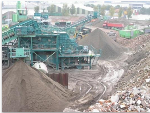
Μονάδα ανακύκλωσης αποβλήτων Κ&Κ. Πηγή: FIR
